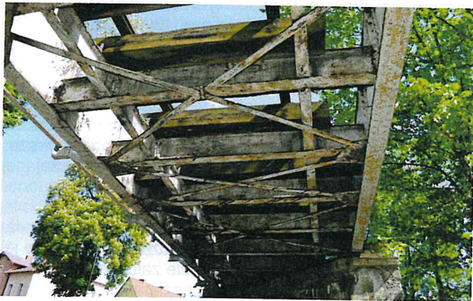
Rys. 3. Widok ogólny przęsła obiektu w km 79.005 l. 285 – oparcie mostownic na wiotkich podłużnicach niestężonych bocznie (fot. Maciej Kożuch)
